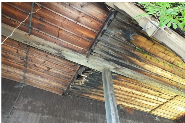
Poškození podhledu verandy ve střední části – pod úžlabím mezi krovů vikýřů.
