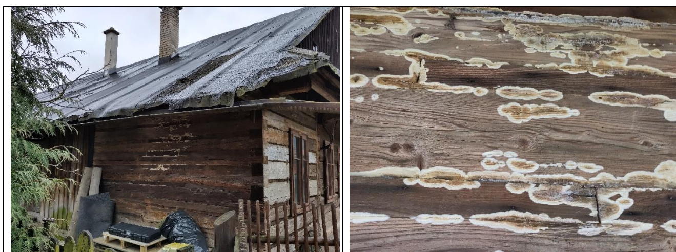
Severní část východní roubené stěny (pohled a detail) – plodnice dřevokazných hub na trámech roubení pod místem s porušenou střešní krytinou – stav pře provedením prvotní sanace (foto T. Dostál).
