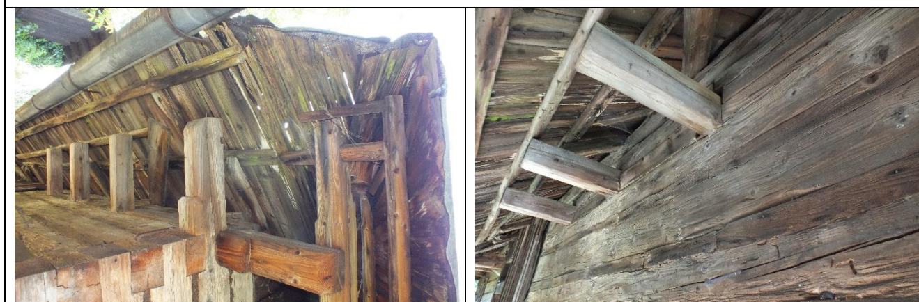
Poškozený střešní plášť v severovýchodní části objektu.
