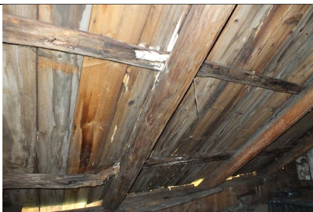
Poškození šindelové krytiny a krovu v střední části východní střešní roviny.
