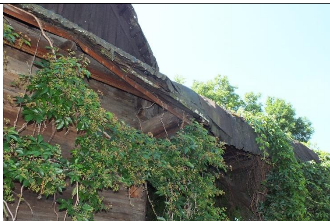
Poškození patní části krovu vikýře a střechy verandy v severní části objektu.
