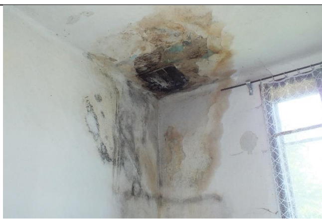
Místnost v severovýchodní části objektu – kolaps části nosné stropní konstrukce.
