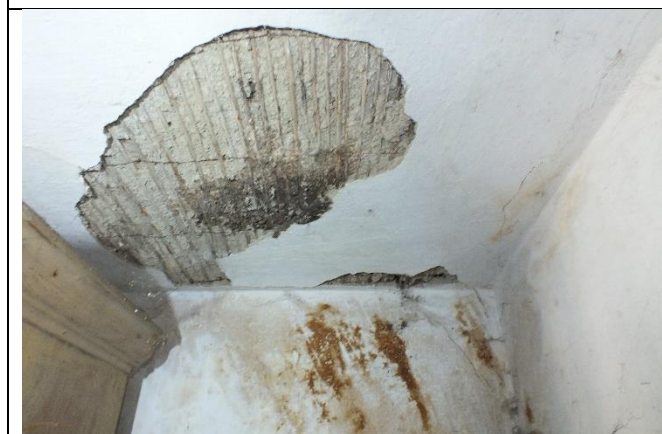
Místnost v severovýchodní části objektu – odpadnutí části podhledu.
