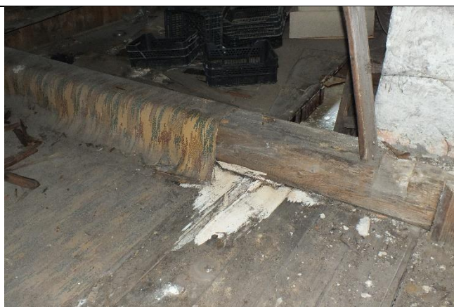
Poškození vazného (stropního) trámu a prkenné podlahy půdy.
