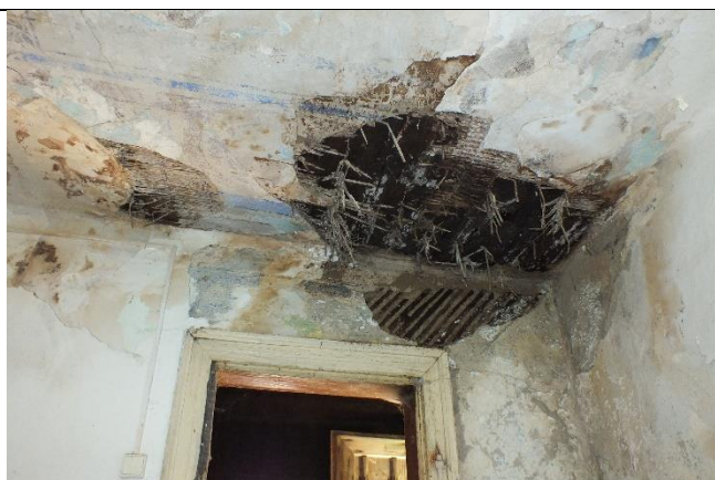
Místnost v jihovýchodní části objektu – kolaps části nosné stropní konstrukce.
