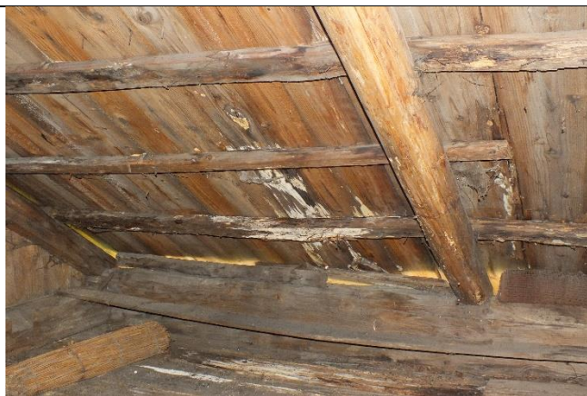
Poškození šindelové krytiny a krovu v severní části východní střešní roviny.
