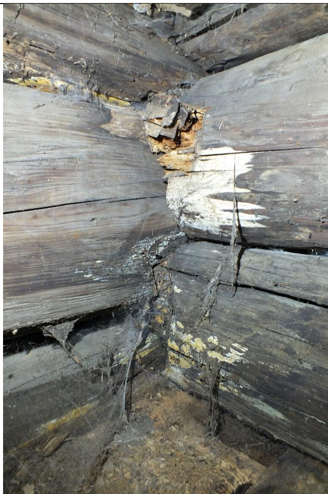
Severozápadní nároží roubené komory – poškození konců trámů působením dřevokazných hub.
