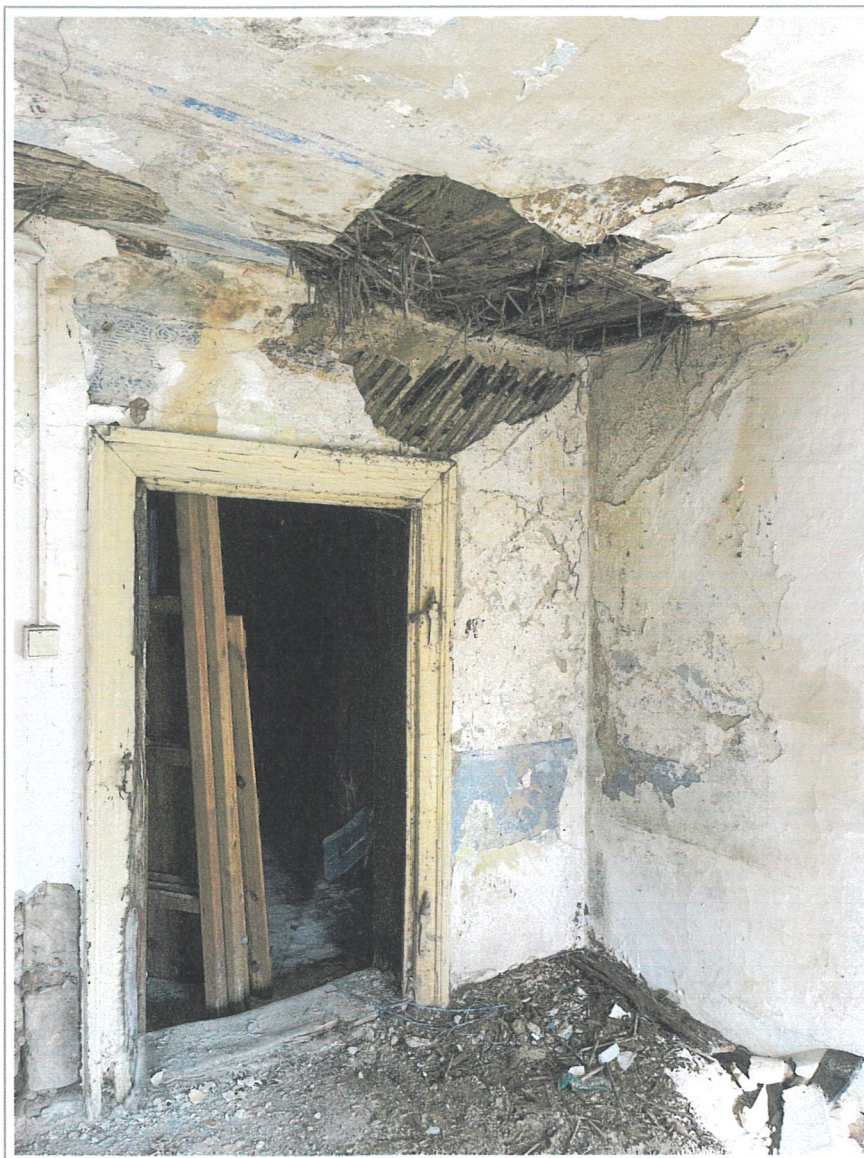
Obr. č. 29.: Pohled do severozápadního rohu místnosti za světnicí. Na snímku je zachycen havarijní stav stropu, odhalené části historické výmalby, rákosové podbití na stropě a laťové bednění na stěnách. Historická výmalba je definována modrým olinkovaným soklem, který navazuje na jemný modrý dekor na bílém pozadí. Následuje starší vrstva stejné barevnosti s jednoduchým geometrickým dekorem a pod touto vrstvou se nachází nejstarší barevná vrstva definovaná šedo-modrou barevností.
