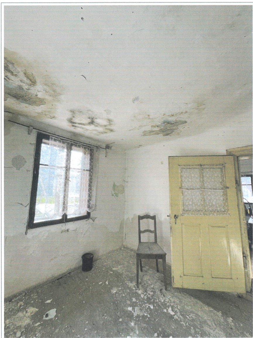
Obr. č. 30.: Pohled do jihovýchodního rohu místnosti za světnicí. Na stropě jsou patrné stopy po zatečení, jež způsobilo poškození barevných a omítkových vrstev. Na snímku jsou též viditelné oblasti napadené plísněmi. V soklových partiích je přítomno zavlhčení, patrně způsobené vztlínající vlhkostí.
