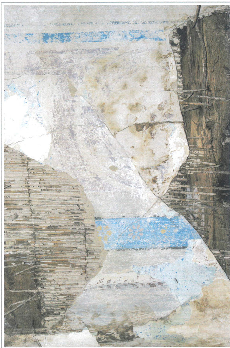
Obr. č. 37.: Pohled na strop místnosti za světnicí. Samoodkryvem zde byla odhalena nejstarší vrstva výmalby. Jedná se o bohatou dekorativní malbu, jejíž stav dochování je velice špatný. Ze snímku je patrné, že také stav dochování podkladních omítek, rákosového podbití i dřevěné konstrukce stropu je v této oblasti havarijní.
