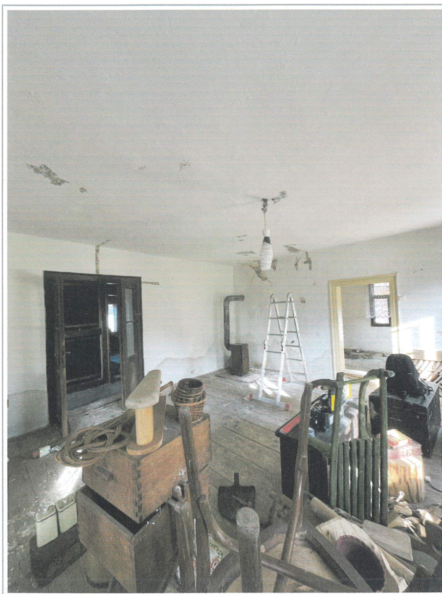
Obr. č. 28.: Světnice, pohled do severozápadního rohu. V soklové části je zřetelné zavlhčení stěn. Zavlhčení je patrně způsobeno vzlínající vlhkostí.
