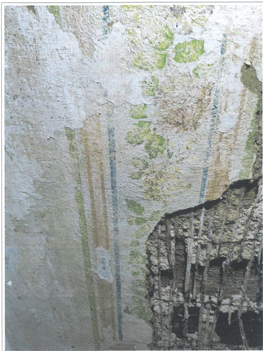
Obr. č. 39.: Pohled na strop místnosti vzadu vlevo (dnešní koupelna). Na snímku jsou patrné pozůstatky dekorativní výmalby. Typově shodné s nejstarší dochovanou vrstvou v místnosti za světnicí. Vlivem zanedbané údržby a následnému zatékání srážkové vody došlo ke značnému poškození stropní konstrukce, rákosového podbití, podkladní omítky i malby samotné. Autor snímku: Tomáš Dostál, březen 2024.
