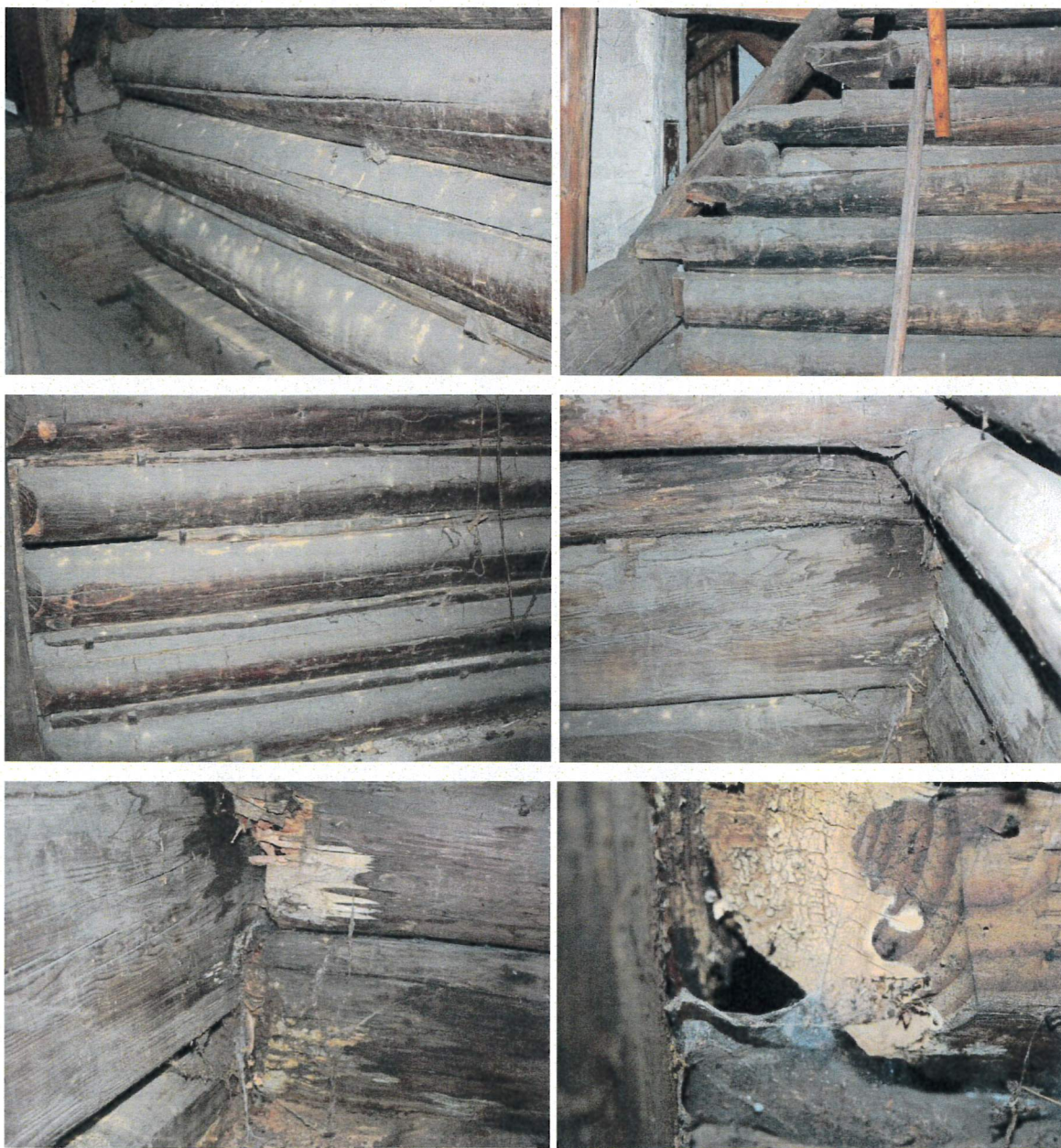
FOTO 5: Detaily stavu vnitřních roubených stěn komory. Patrné je poškození dřevokazným hmyzem, červotočem proužkováním ( Anobium punctatum ). Stupeň poškození, je nízký. V rohovém spojení v místě zatékání do krovu a dále do roubení, je patrné poškození dřevokaznými houbami z oddělení Basidiomycota. Poškození je lokální.
