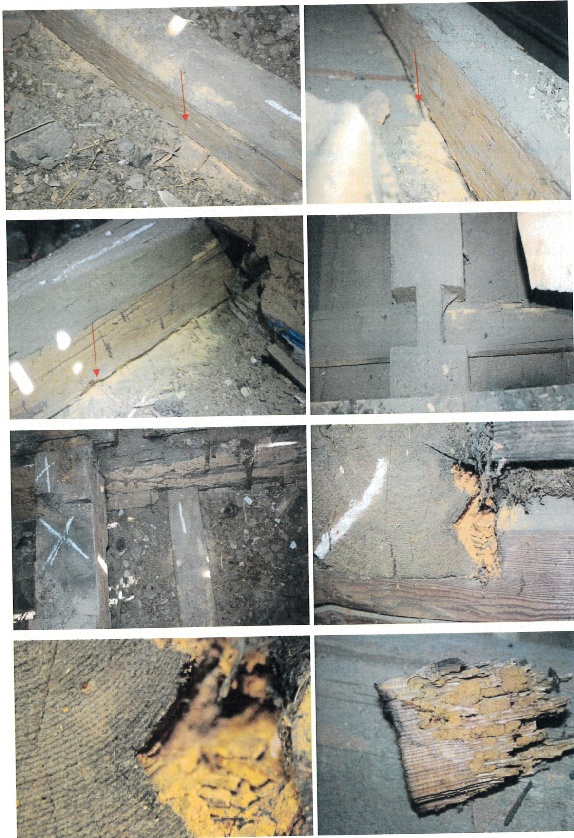
FOTO 01: Detaily stavu stropní konstrukce nad místností č. 102. Poškození je způsobené dřevokazným hmyzem i dřevokaznými houbami. Nalezena byla plodnice dřevokazné houby
