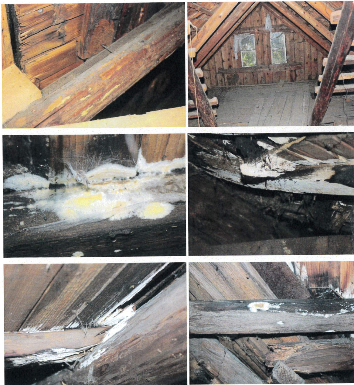
FOTO 04: Stav krovové konstrukce je na několika místech zejména na východní straně objektu masivně poškozen dřevokaznými houbami i hmyzem. Stav střešního pláště je havarijní. Patrné jsou plodnice dřevokazných hub, zejména poprašky sklepní ( Coniophora puteana ). Zasaženy jsou střešní latě i krokve. Krov nad místností č. 102 je v každé vazbě stažen prvkem. Krov na východní straně objektu, nad místností č. 103, je staticky zajištěn a podstojkovan.
